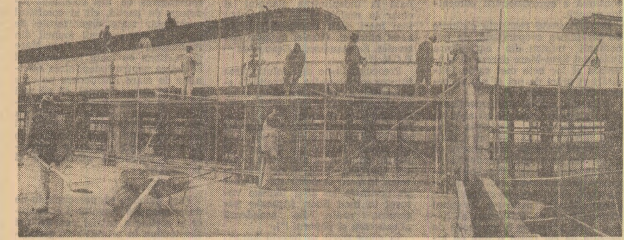
La COMBINATUL DE ARTICOLE TEHNICE DIN CAUCIUC JILAVA se desfășoară în ritm intens lucrările de investiții la un nou obiectiv. Activitatea echipei de zidari condusă de Gheorghe Șovărel este concentrată la încheierea halei (în fotografie). În acest fel se creează condiții optime pentru continuarea lucrului pe perioada de iarnă. Sudorii din formația condusă de Alecu Toma efectuează montarea lîmpilor electrice.
