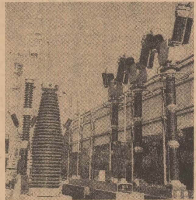
În preajma macaralelor turn fabricate la Bocșa, s-a instalat standul „fulgerelor”: întreruptoarele de înaltă tensiune realizate de binecunoscuta uzină craioveană „Electroputere”
