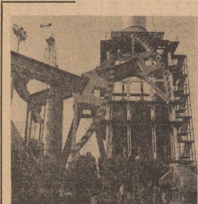
Montorii uzinei bucureștene „Vulcan” cu încheiat lucrările de instalare a principalului lor exponat: cazanul de 100 gigacalorii.
