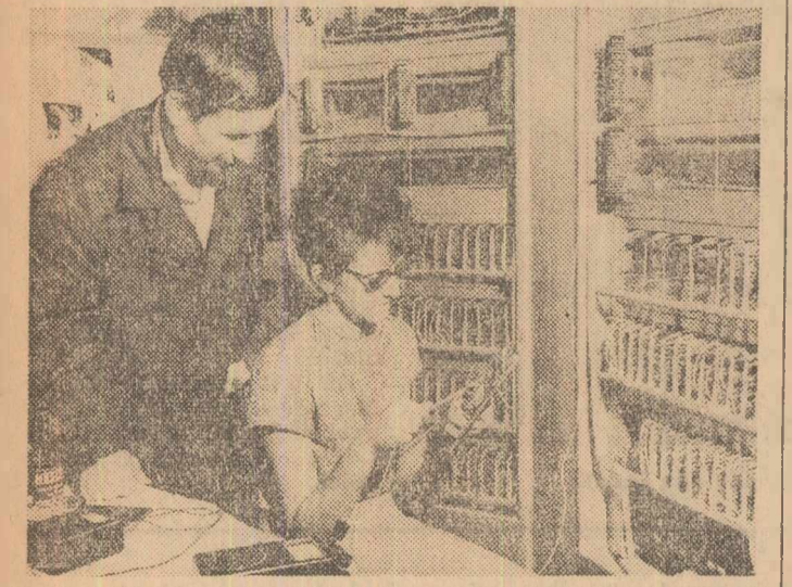
La întreprinderea pentru raționalizarea și modernizarea instalațiilor energetice, ing. Marieta Bănică și muncitorul N. Molnar efectuează măsurători de control la un nou echipament de telemecanică de tip T.C.U. Acest aparat este folosit pentru comanda la distanță a aparatului de înaltă tensiune
