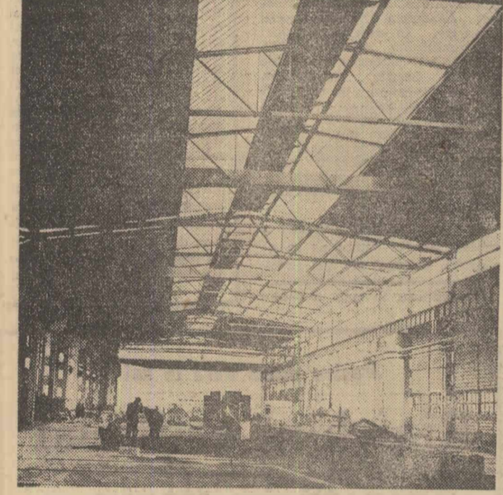
Pe santierul Fabricii de osii și boghiuri, aflată în construcție la Bals, județul Olh, au fost executate cheșoanele de beton care formează fundațiile preselor de 6.300 și 2.300 tone forță. Pe același santier se execută lucrările de acoperire a halelor de prelucrare la cald și la rece, pe care vi le prezentăm mai sus
