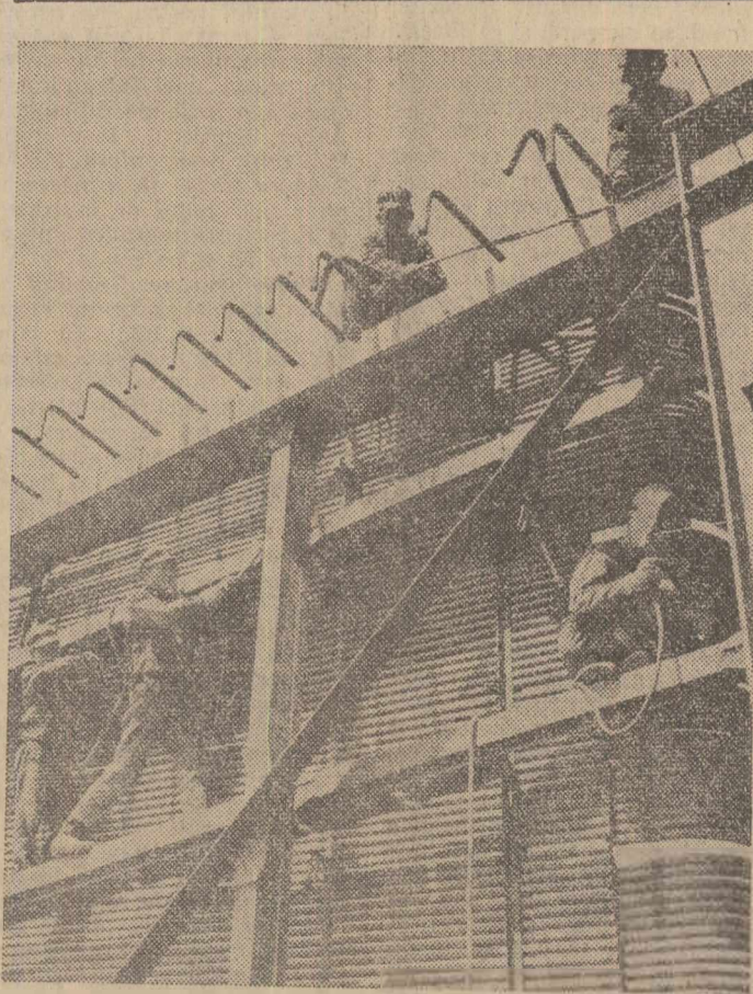
Pe șantierul termocentralei de la Deva, o echipă de montori condusă de Manchen Wilhelm execută reglajul fâvării la blocurile spațiale ale cazanelor de abur
