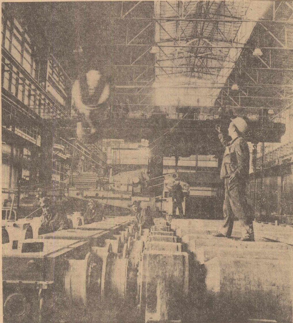
Laminorul Bluming de 1.300 mm ce se construiește în aceste zile la Hunedoara
