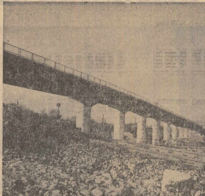
Pe drumul național Rădăuți-Ratoș s-a dat recent în folosință podul Dornești, construit din grinzi de beton comprimat cu 18 deschideri. Foto: FLORIN ȘTEFĂNESCU
