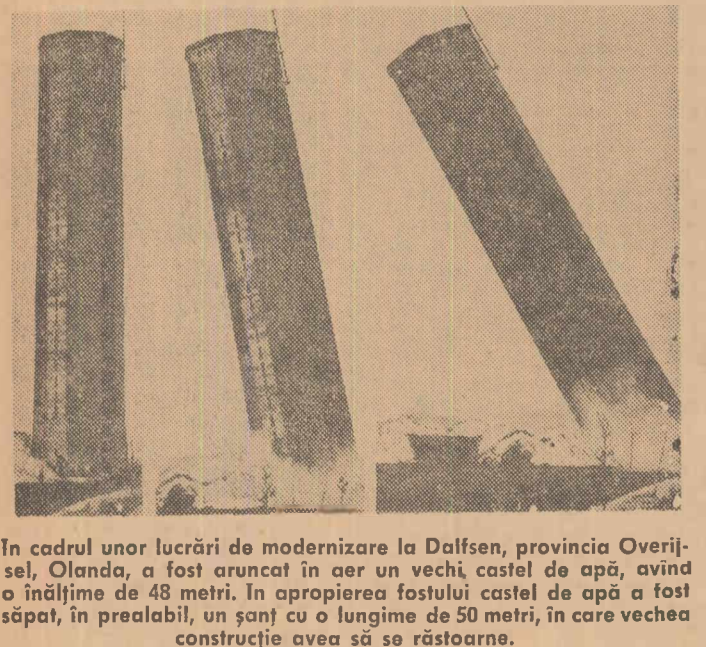
În cadrul unor lucrări de modernizare la Dalfsen, provincia Overijssel, Olanda, a fost aruncat în aer un vechi castel de apă, avînd o înălțime de 48 metri. În apropierea fostului castel de apă a fost săpat, în prealabil, un șanț cu o lungime de 50 metri, în care vechea construcție avea să se răstoarne.
