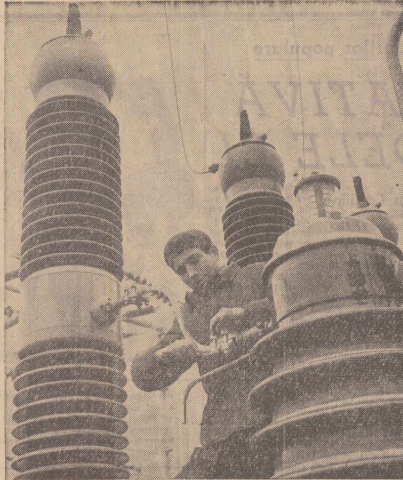
Gh. Bogde, lăcătușul stației de transformare de 110 Kw. de la hidrocentrala „V. I. Lenin” de la Bicaz, execută ultimele legături ale circuitelor primare ale întrerupătoarelor cu aer comprimat
