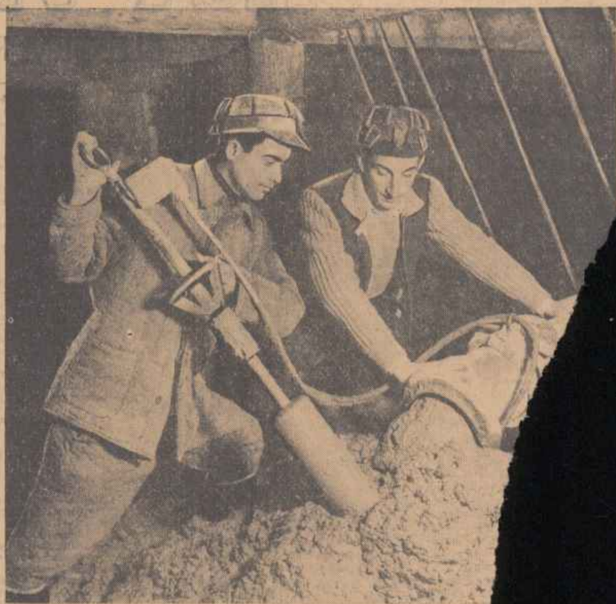
La unul din tronșoanele prizei de apă. Mecanicul șef Spandonide Egon verifică de la suprafață cimentul. Alături de el minăind vibratorul se află brigadierul Gheorghe Fot.
