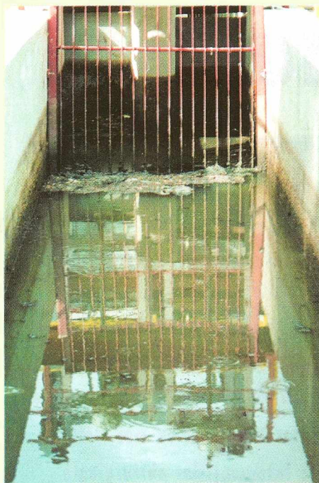
Grătar de filtrare primară a apelor uzate
