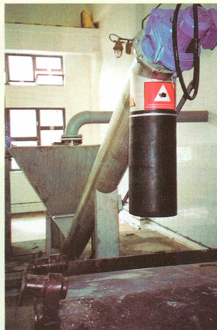
Aspecte din camerele stației de epurare
